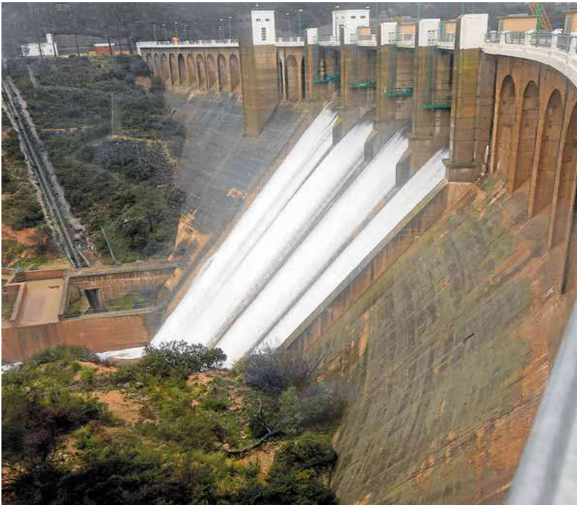
Presa de Forata, en Yátova, tras las reparaciones posteriores a la dana. IVÁN ARLANDIS
